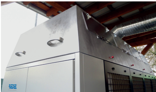
| Kühlanlage mit Abzugshaube zur Wärmerückgewinnung im Außenbereich © SLV Service GmbH
